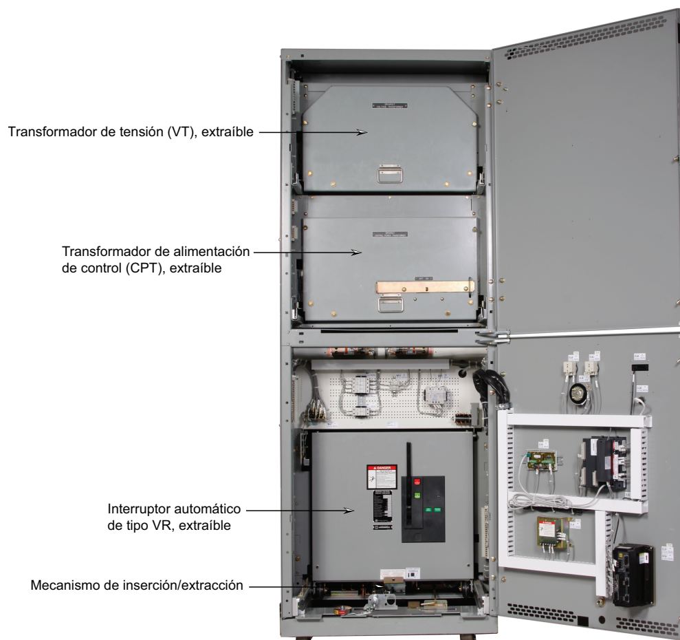
Figura 1 - Ensamble típico de un tablero de fuerza Masterclad con revestimiento metálico
